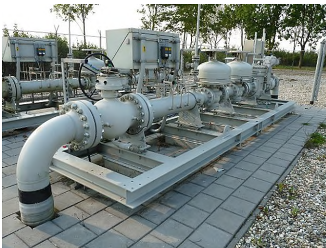
Figuur 3-10 Foto van een meet- en regelstation voor aardgastransport. Van het waterstof gasontvangstation is nog geen ontwerp beschikbaar. Het waterstof gasontvangstation zal naar verwachting qua omvang, hoogte en zichtbeleving vergeleken kunnen worden met dit meet- en regelstation (Bron: HNS)
