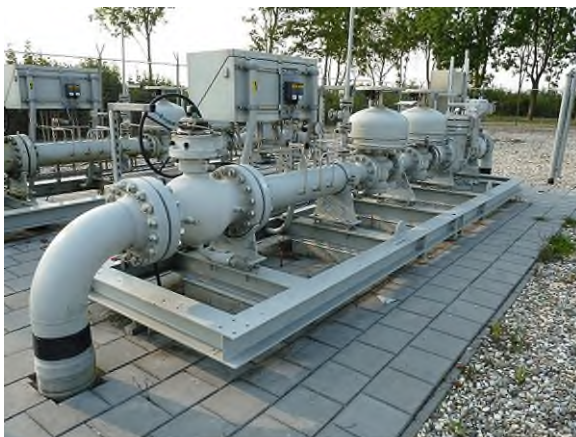
Figuur 3-10 Foto van een meet- en regelstation voor aardgastransport. Van het waterstof gasontvangstation is nog geen ontwerp beschikbaar. Het waterstof gasontvangstation zal naar verwachting qua omvang, hoogte en zichtbeleving vergeleken kunnen worden met dit meet- en regelstation (Bron: HNS)
