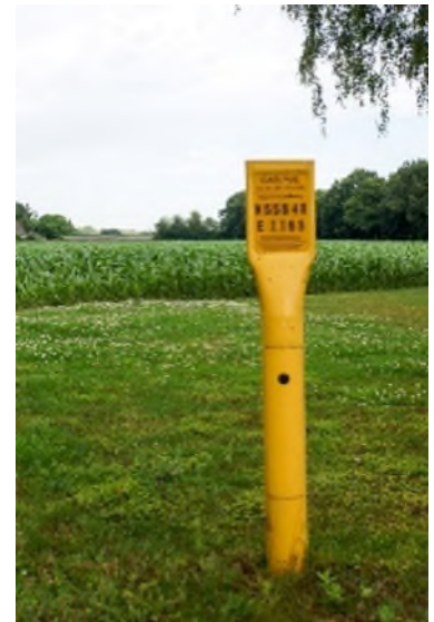
Figuur 4-2 Beeld van een gas- of waterstofleiding in de gebruiksfase
