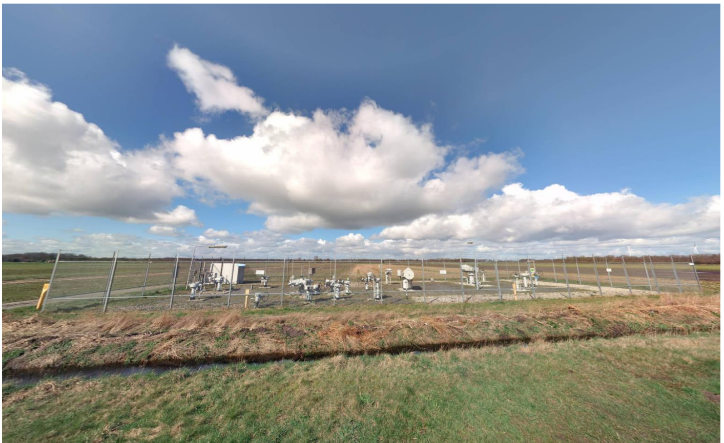
Figuur 3-1 Voorbeeld bestaande afsluiterlocatie aardgasleiding (S-216 Gasselternijveen)
