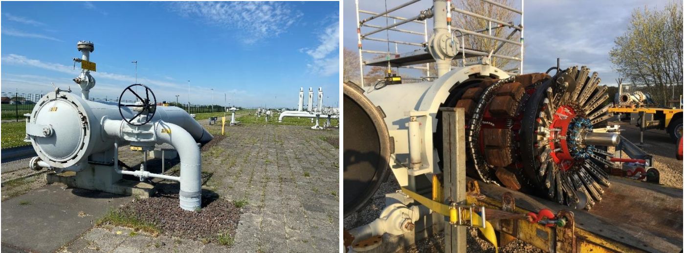
Figuur 3-2 Voorbeeld van pigfaciliteit (links). Bovengronds kan de pig worden ingebracht en wordt via de pigfaciliteit naar de ondergrondse leiding geleid. Rechts wordt het inbrengen van een pig weergegeven.
