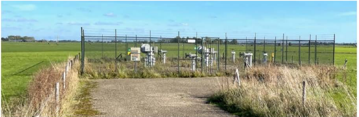
Figuur 3-11 Voorbeeld van een omheinde afsluiterlocatie voor drie parallel gelegen leidingen. Bij één leiding is de oppervlakte 1/3 van deze locatie (bron: HNS, 2022)
