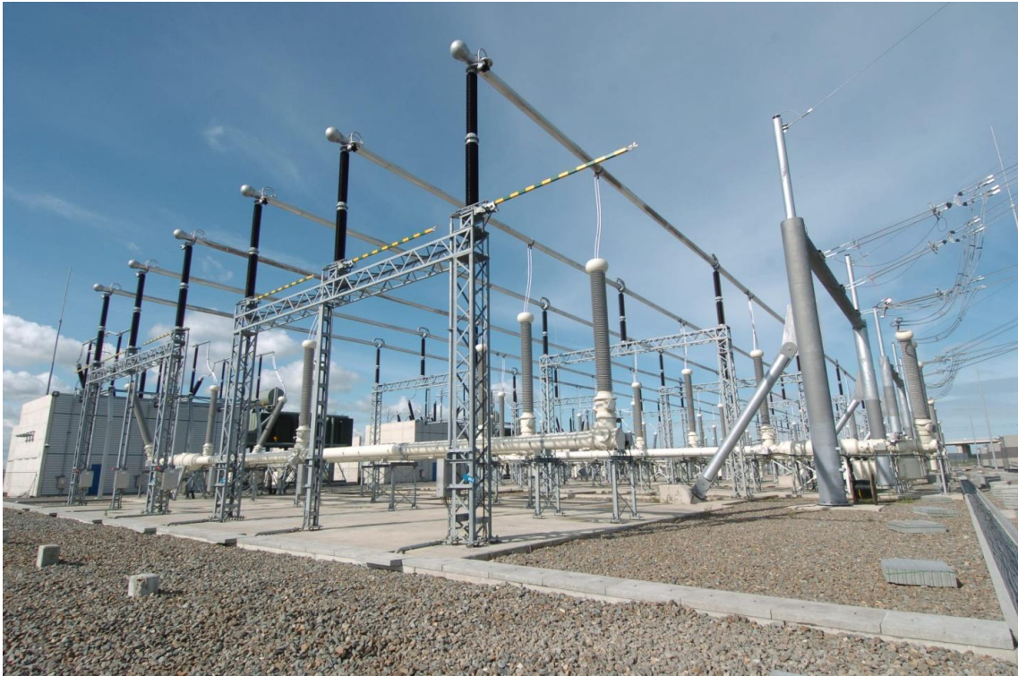
Afbeelding 5: Voorbeeld van een veld met schakel- en meetapparatuur
