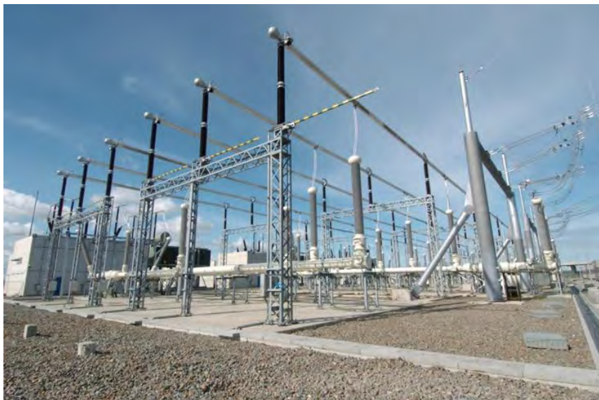
Foto 17: Impressie van een veld met schakelapparatuur
