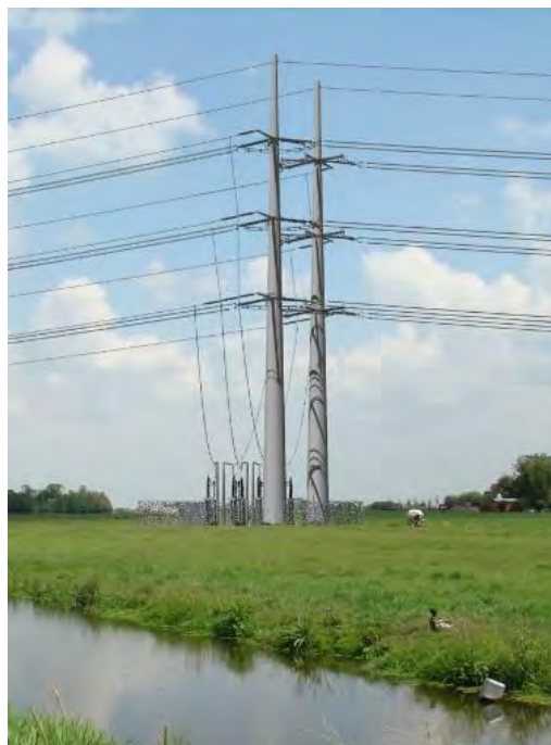
Foto 21: Impressie opstijgpunt 150 kV bij een Wintrackmast
