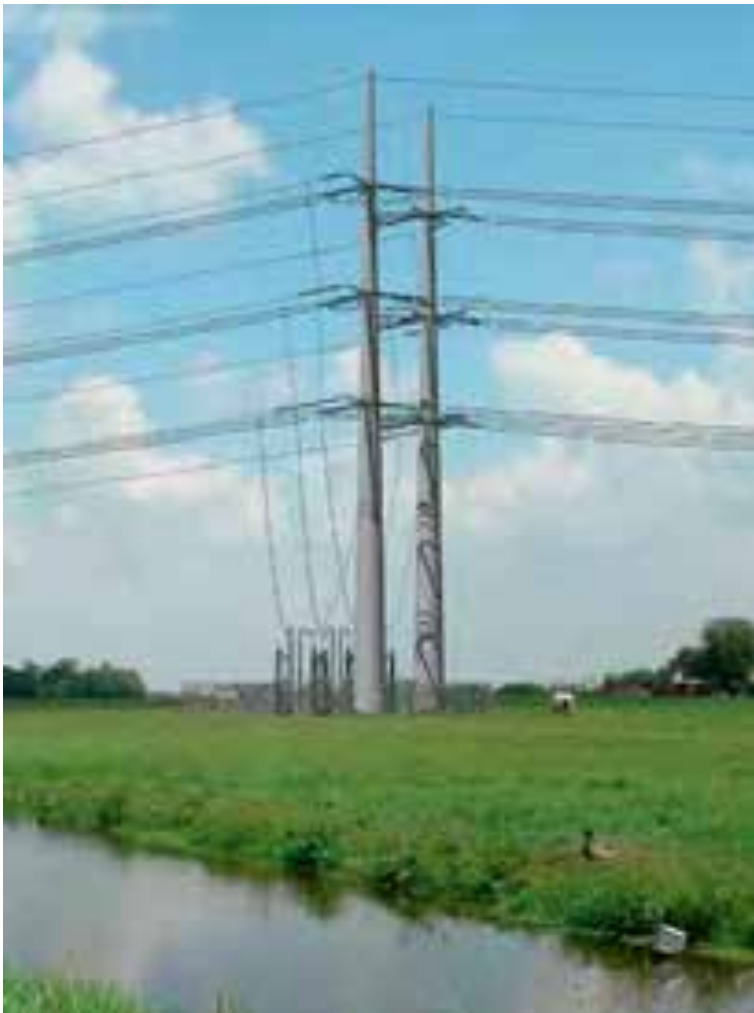
Figuur 62 Impressie van opstijgpunt 150kV bij een Wintrackmast.
