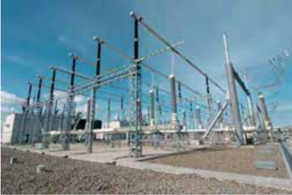
Foto 1 Foto van een veld met schakelapparatuur.
