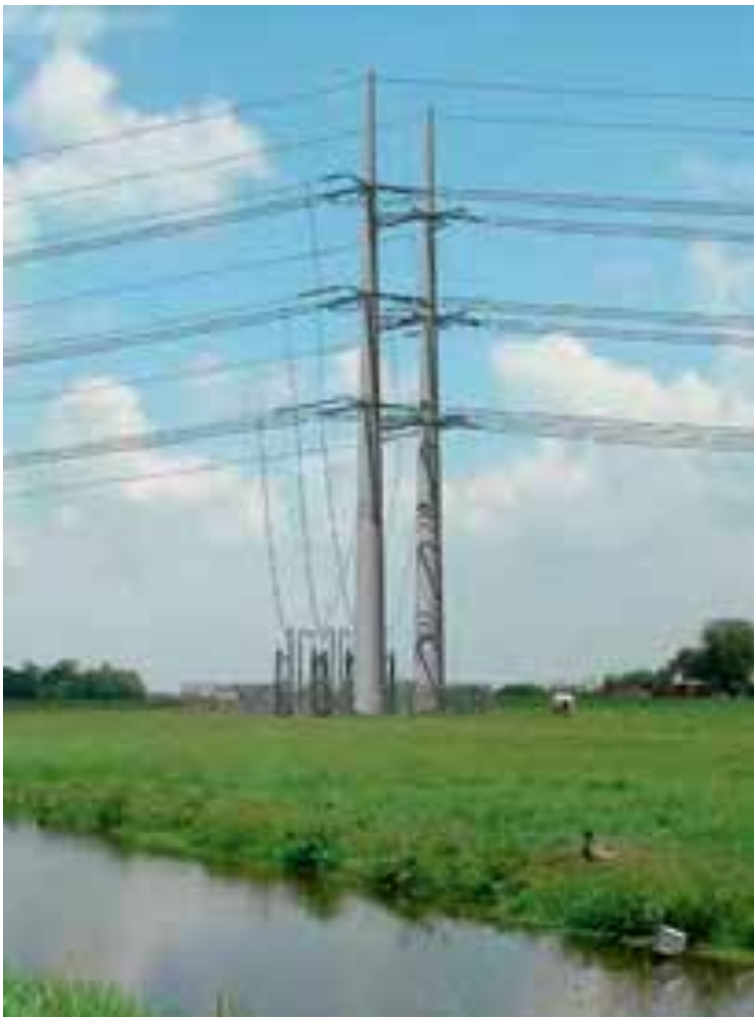
Figuur 15 Impressie van opstijgpunt 150kV bij een Wintrackmast.
