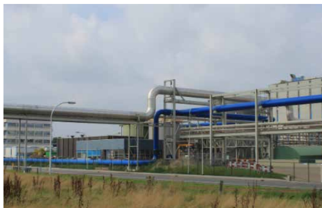
Inkomende stoomleiding Twence (vanaf links) bij AkzoNobel Industrial Chemicals (Foto: B.Konneman/Ecofys)
