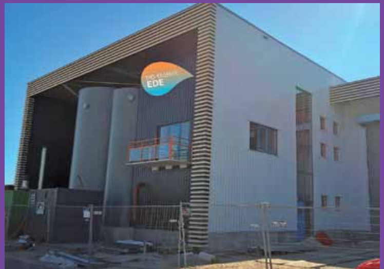
Bio-Energie Ede, de tweede energiecentrale van het groene warmtenet in Ede.
