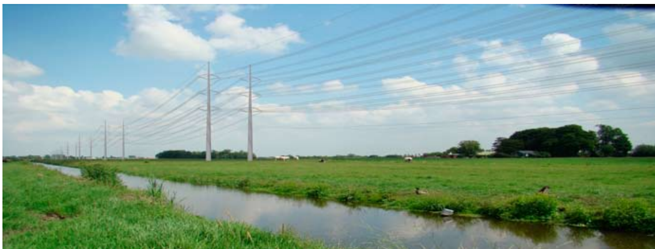
Afbeelding 4.1 Een gecombineerde vier - circuits Bipole-mast
