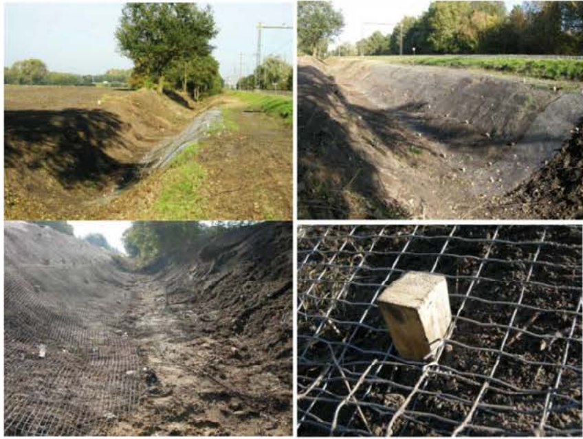
Foto 1: Gaaswerk wat in 2009 is aangebracht in het talud bij Epse naar aanleiding van een burcht aan de zijde van het weiland (bron: Stichting Das&Boom).
