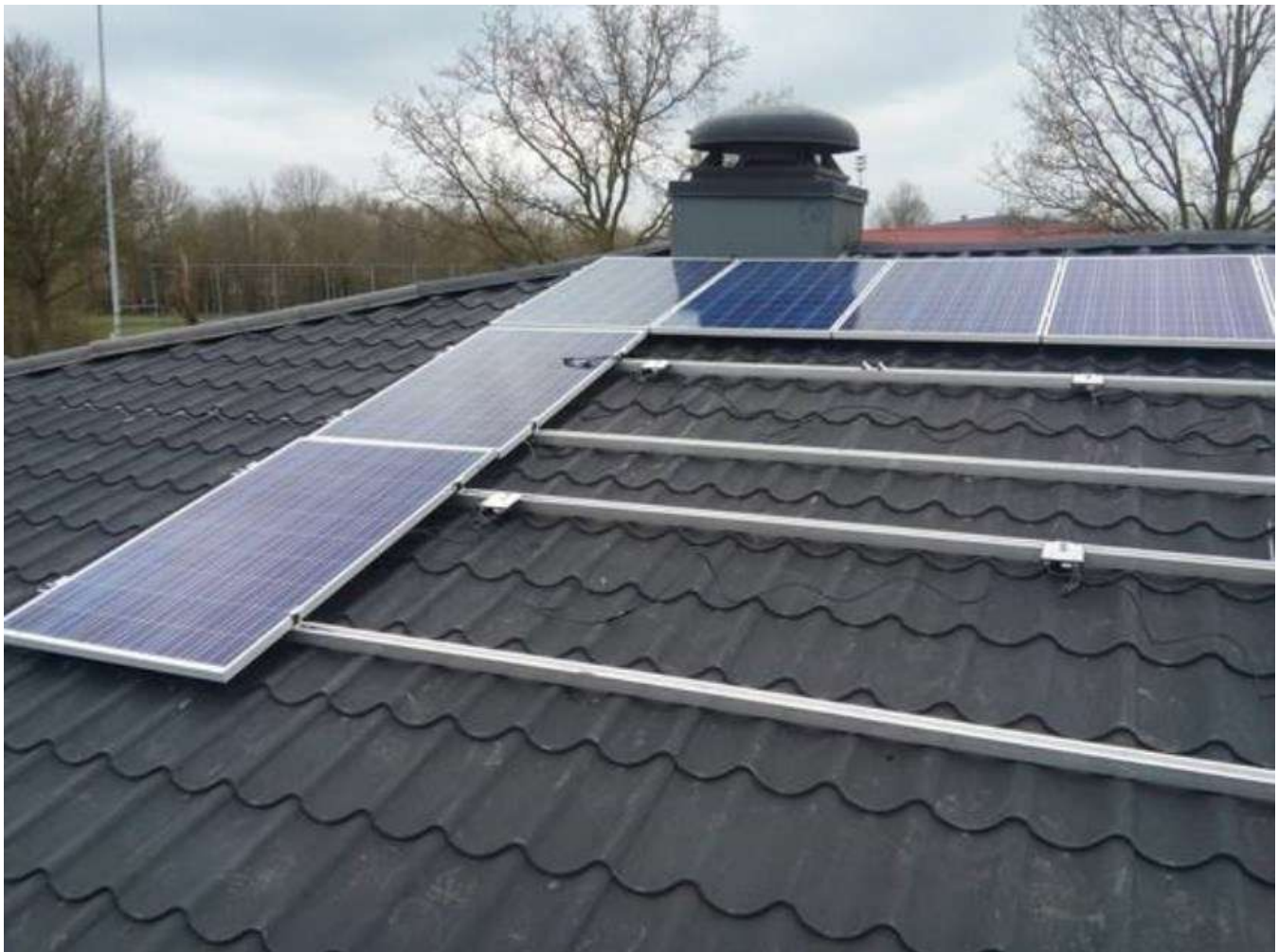
Figuur 11 Horizontale bevestigingslatten onder zonnepanelen
