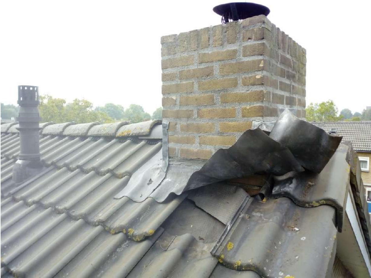
Paarverblijf gewone dwergvleermuis onder loodslab. Project van St Joseph in Boxtel (Bron: Arcadis)
