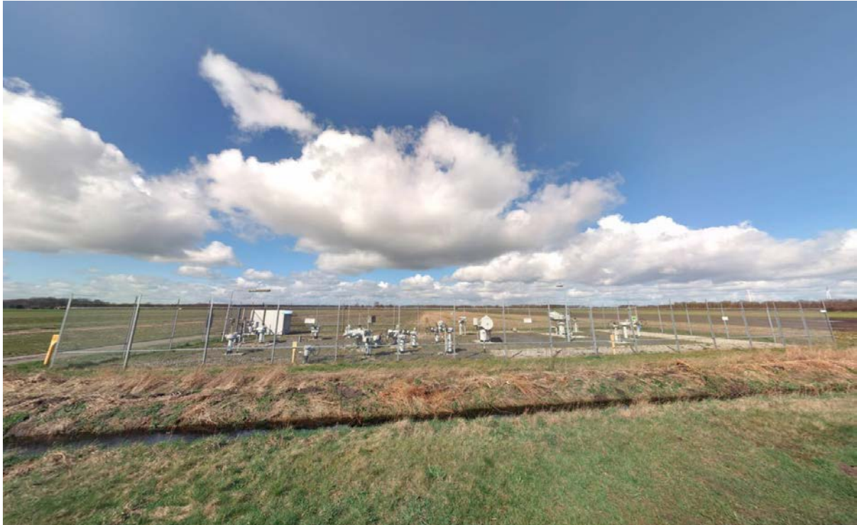
Afbeelding 4. Voorbeeld bestaande afsluiterlocatie voor aardgasleiding (S-216 Gasselternijveen)
