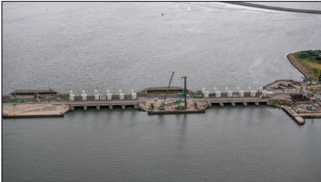
Figuur 2.9 Werkzaamheden voor de aanleg van de nieuwe spuigroep 1.7 (foto: [REDACTED] / Rijkswaterstaat).
