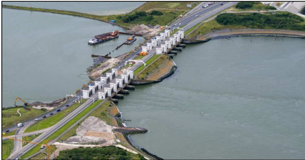
Figuur 2.12 Werkzaamheden aan de flexibele bodembescherming aan de IJsselmeerzijde van het spuicomplex Kornwerderzand (foto: [redacted] / Rijkswaterstaat).
