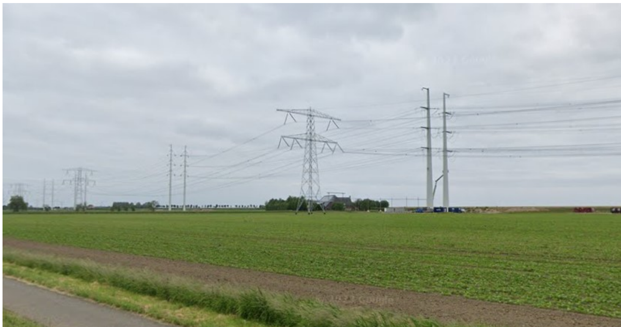
Figuur 4.2 Naast elkaar een 380 kV vakwerkmast ('Eiffeltoren') en een 380 kV wintrackmast (pilaren) (bron: Google Streetview, t.p.v. A58/N289 nabij Rilland)
