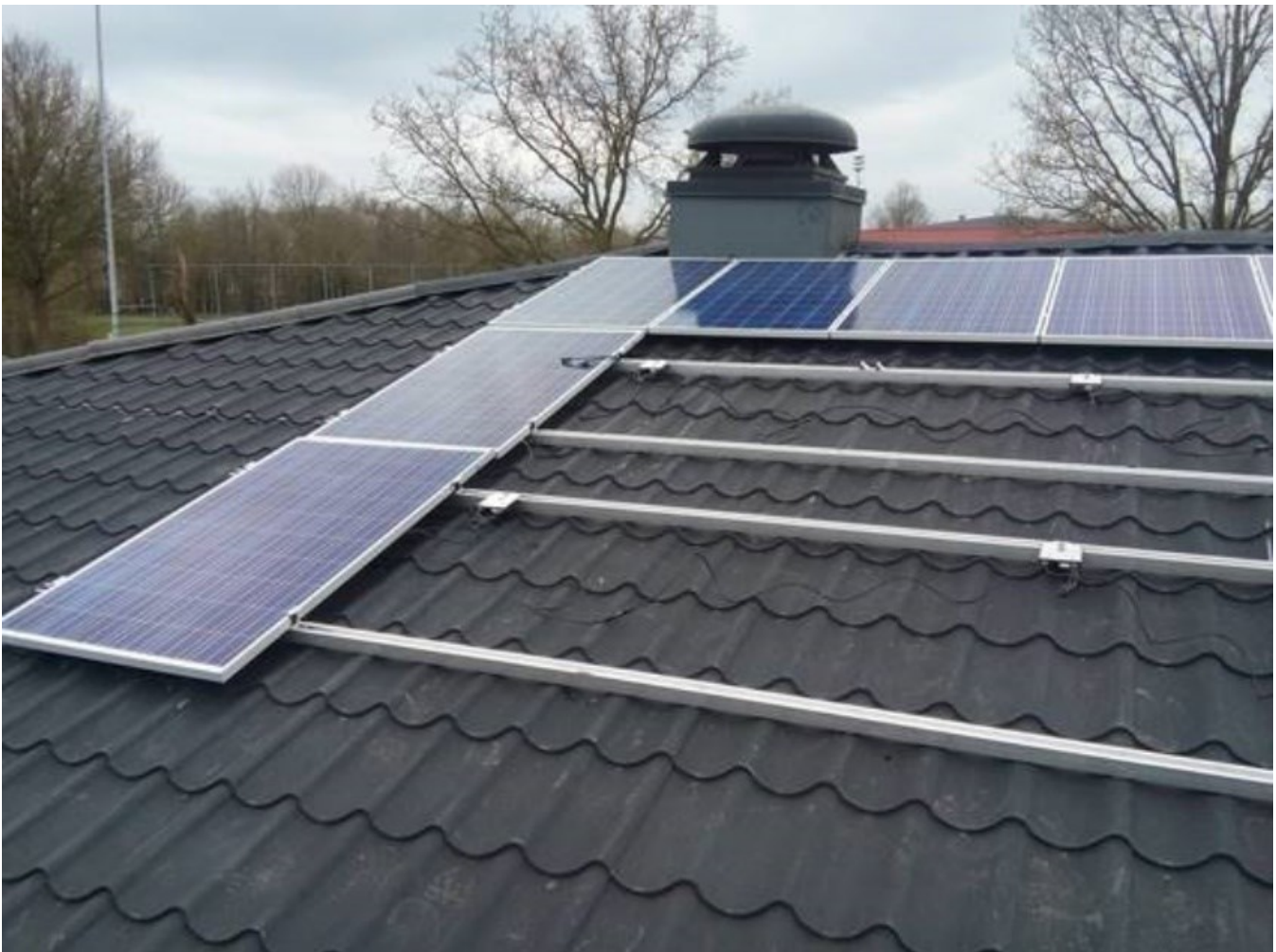
Figuur 11 Horizontale bevestigingslatten onder zonnepanelen
