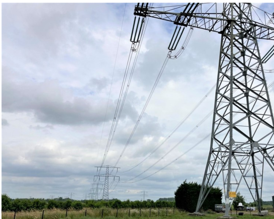
Figuur 2.3 Foto van een 380 kV-hoogspanningsverbinding
