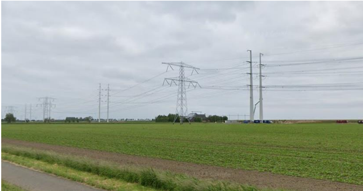
Foto met naast elkaar een 380 kV vakwerkmast ('Eiffeltoren') en een 380 kV wintrackmast (pilaren) (bron: Google Streetview, ter plaatse van A58/N289 nabij Rilland)
