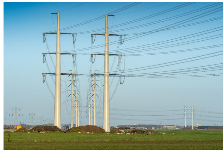
2 wintrackpylonen met 4 stroomcircuits
