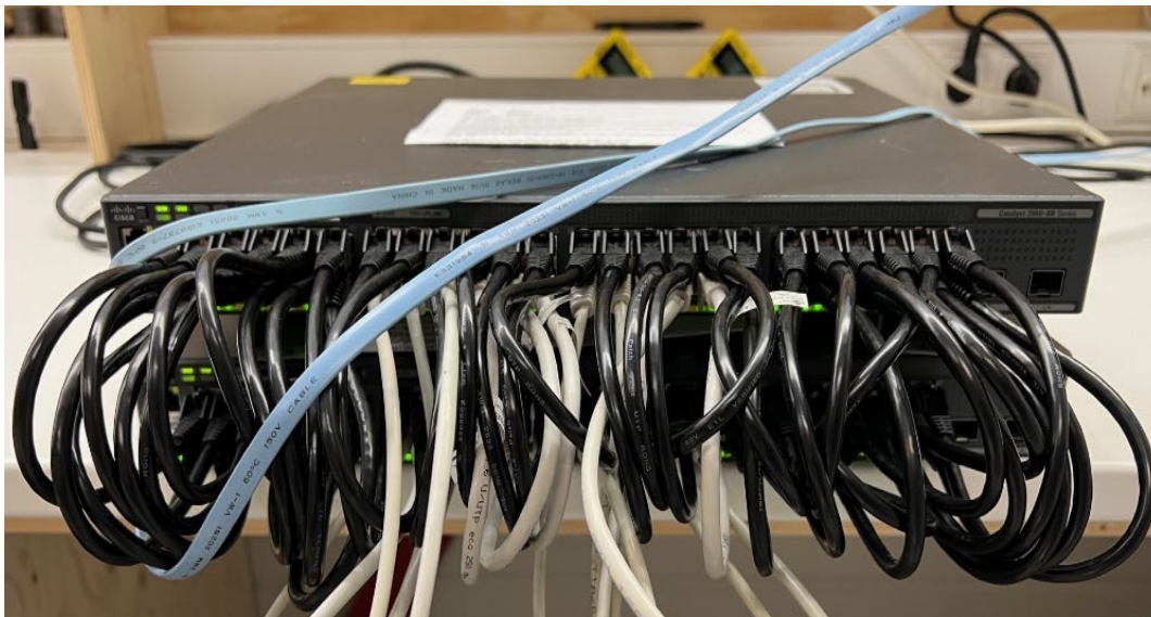
figuur 3: twee 48 poort switches volledig bekabeld
