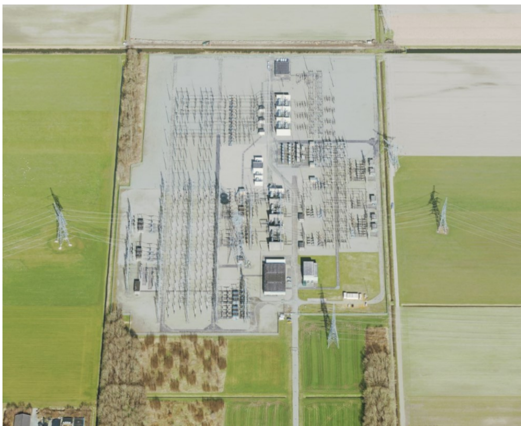
Figuur 1.4 Referentiebeeld 150-380 kV hoogspanningsstation
