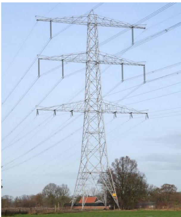
Figuur 3.6: Voorbeeld van een combimast, de 380kV fasen hangen hoog op de bovenste traversen, de lagere spanning onderin. (Bron: hoogspanningsnet.com)
