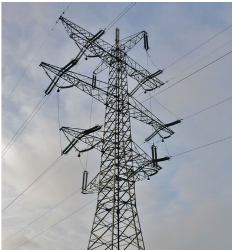
Figuur 10.6: Wisselmast (bron: hoogspanningsnet.com)
