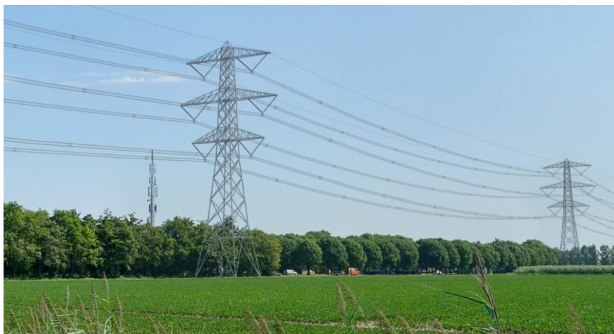
Figuur 10.5: Visualisatie van een Moldau mast in het landschap (bron: projectatlas Zuid-West 380kV-oost).
