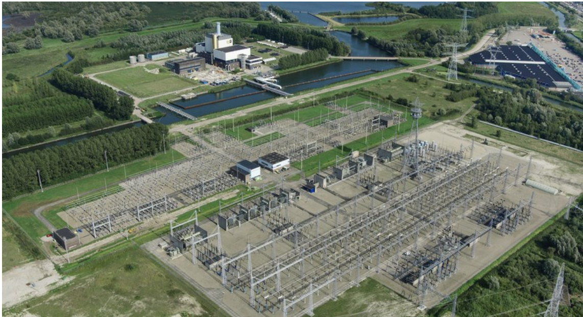
Afbeelding 3.1 380/150 kV-hoogspanningsstation Diemen (Bron: TenneT)
