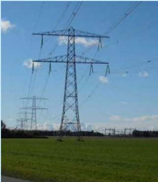
150kV solo steunmast Donau
