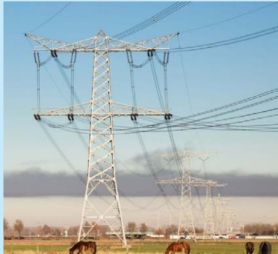
150kV hoekmast Donau
