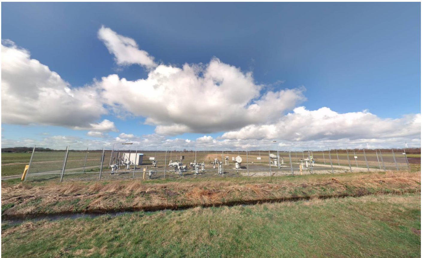
Figuur 3-1 Voorbeeld bestaande afsluiterlocatie aardgasleiding (S-216 Gasselternijveen)
