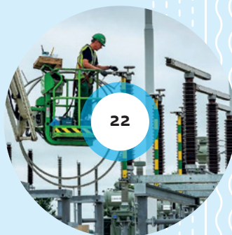
380 kV-netuitbreiding Noord-Holland Noord
