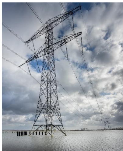
Figuur 3-3 Vakwerkmasten met 2 circuits
