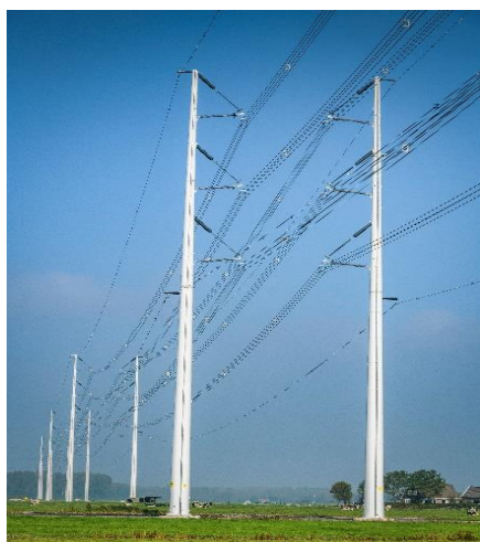
Figuur 3-2 Wintrackmasten met 2 circuits
