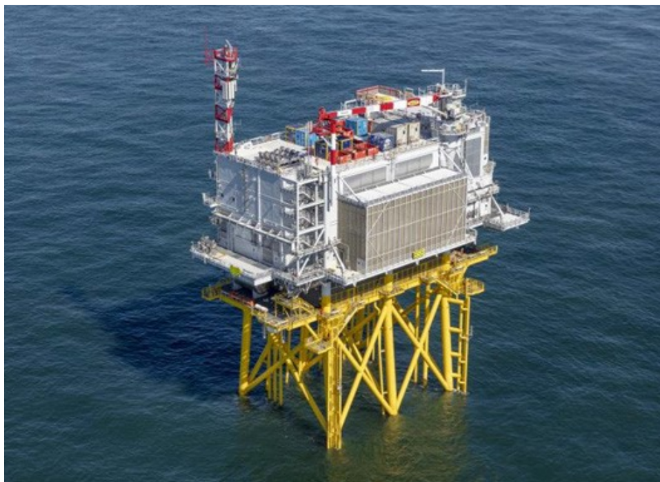
Figuur 4-19 Voorbeeld van een 700MW AC transformatorplatform (Bron: TenneT)
