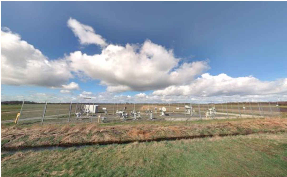
Figuur 3-1 Voorbeeld bestaande afsluiterlocatie aardgasleiding (S-216 Gasselternijveen)
