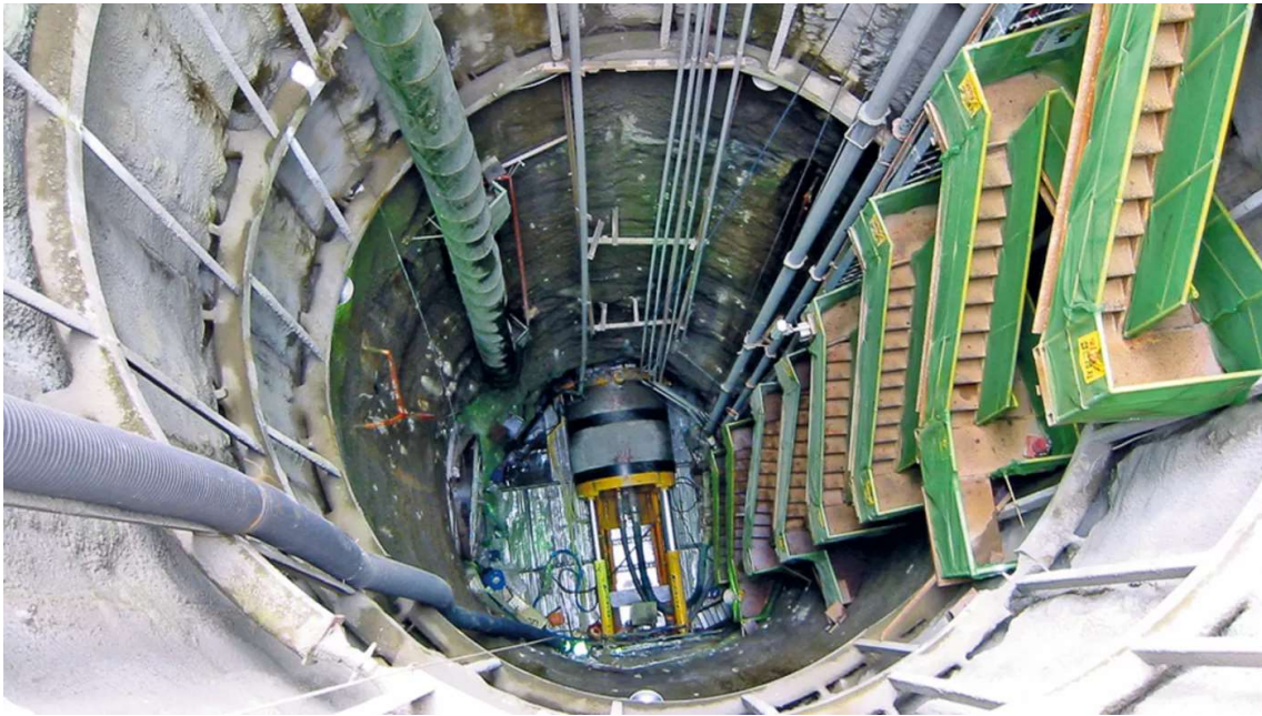
Figuur 2-13 Toegangsschacht voor een Herrenknecht AVN D2400AH (3 m kabeltunnel, https://www.herrenknecht.com/en/references/referencesdetail/seoul-cable-tunnel/ )
