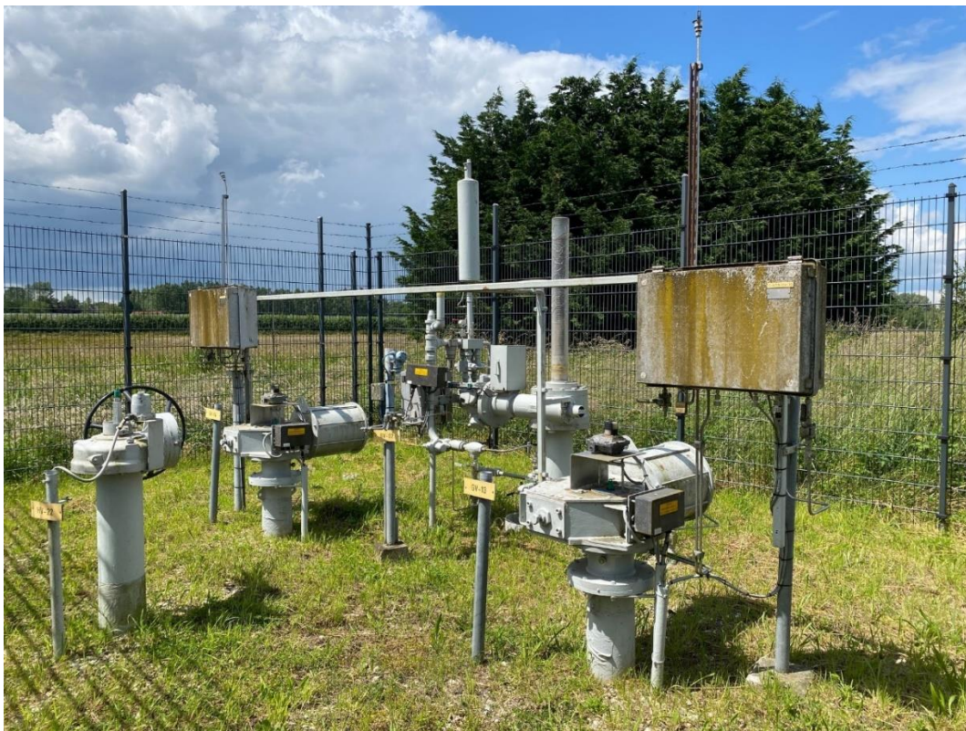
Figuur 4: voorbeeld van het bovengrondse deel van een afsluiterlocatie
