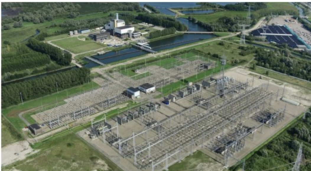
Figuur 2.3 Beeld 380-150 kV-hoogspanningsstation in Diemen (bron: TenneT)
