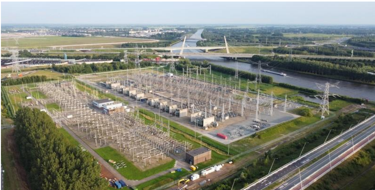
Figuur 1: afbeelding van een 380/150kV openluchtinstallatie (AIS-station)
