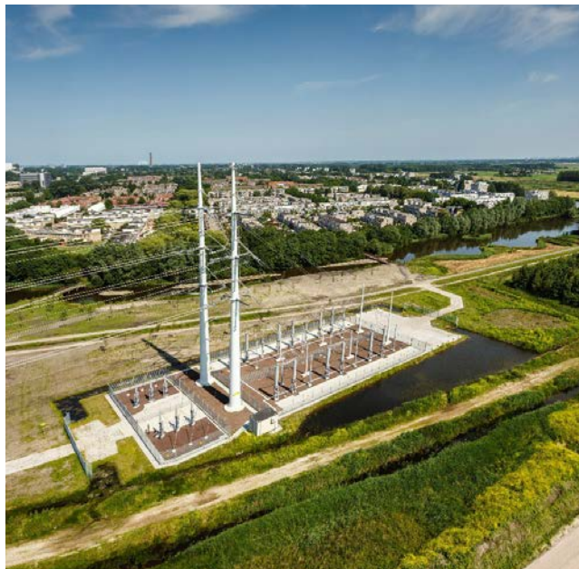
Afbeelding 1: opstijgpunt van een hoogspanningsverbinding in Delft.
