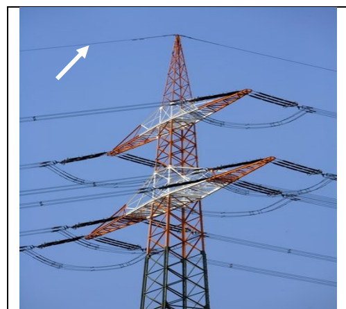
Afb. 3.19: Mast met een bliksemdraad in de top van de mast
