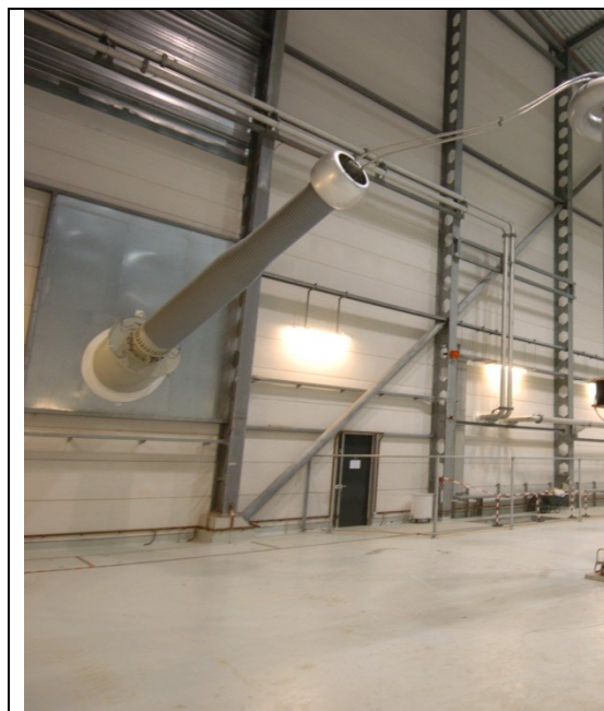
Afb. 4.16: Kabeleindsluiting (met muurdoorvoer) van een HVDC-kabel
