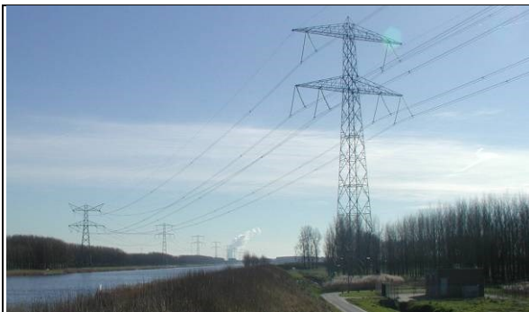
Afb. 3.1: Vakwerkmasten, waarvan de meest linkse een hoekmast is en de rechtse een steunmast is.
