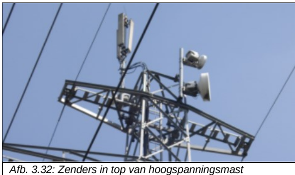
Afb. 3.32: Zenders in top van hoogspanningsmast
