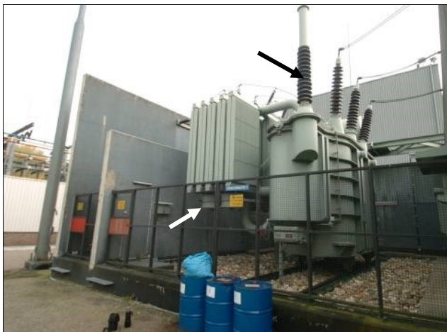
Afb. 2.26: Transformator met zicht op de primaire (hoogspannings-) zijde en van links naar rechts respectievelijk de sterpunt (zie zwarte pijl) en drie fasen aansluitingen. Tevens is ook de ventilator onder koeler – bij witte pijl - goed te zien.
