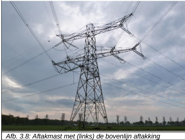
Afb. 3.8: Aftakmast met (links) de bovenlijn aftakking
