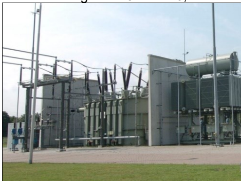
Afb. 1.15: Transformatorcel met scherfwanden en gescheiden transformatorkoeler
