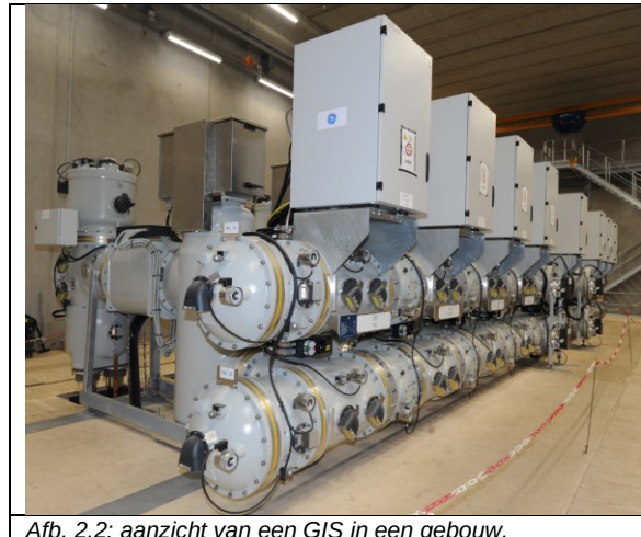
Afb. 2.2: aanzicht van een GIS in een gebouw.
