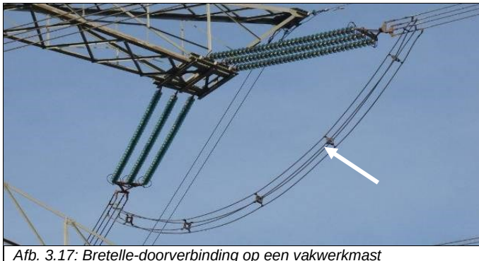
Afb. 3.17: Bretelle-doorverbinding op een vakwerkmast
