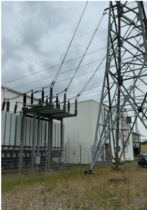
Figuur 3.4.3.1-1 Transformator met terreinafwerking van grind
