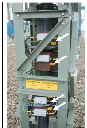
Afb. 2.18: ringkern stroomtransformator (vier stuks) rond een HS-kabel
