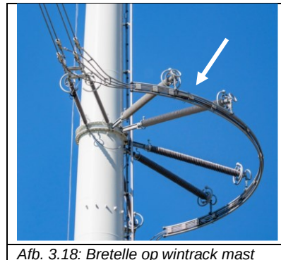
Afb. 3.18: Bretelle op wintrack mast
