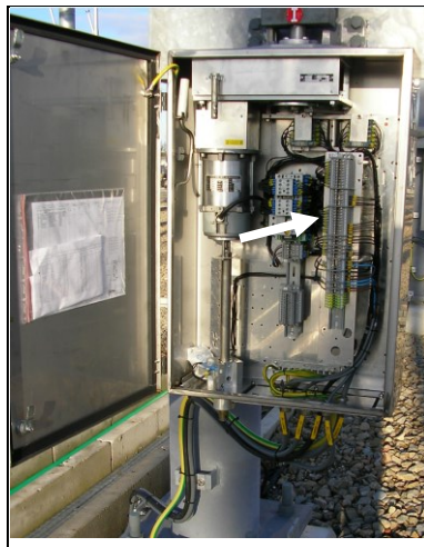
Afb. 5.5: Secundaire aandrijfkast van een schakelaar met zicht op de aandrijfmotor en schakelwals
