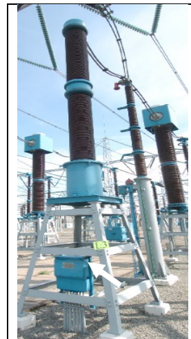
Afb. 5.6: Primaire spanningstransformator met aansluitkast
