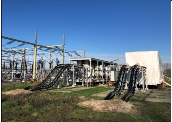
Afb. 2.3: aanzicht van een geplaatste MGU
