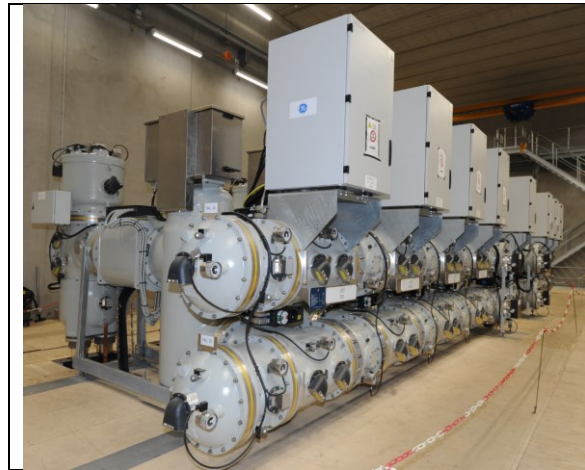
Afb. 2.2: aanzicht van een GIS in een gebouw.
