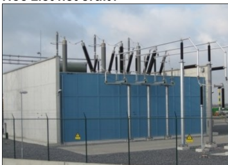
Afb. 1.17: Geluidshuis (blauw) tussen de scherfwanden van een transformator
