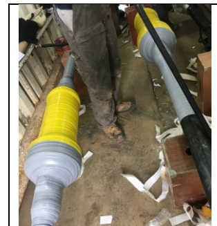
Afb. 4.11: Gesloten 1-fase kabeljoint voor 150kV kabel
