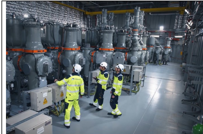
Afb. 2.6: aanzicht van een GIS op een offshore platform
