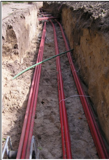
Afb. 4.7: Kabelbed van drie 10kV circuits met elk drie fasen
