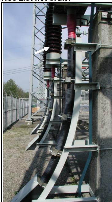
Afb. 4.14: Drie fasen van een eindsluiting op een hoogspanningsstation
