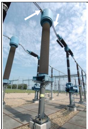
Afb. 2.17: Stroomtransformator met twee HS-aansluitingen
