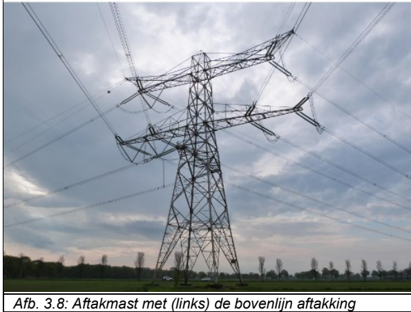
Afb. 3.8: Aftakmast met (links) de bovenlijn aftakking
