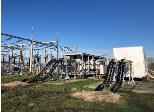
Afb. 1.13: aanzicht van een geplaatste MGU
