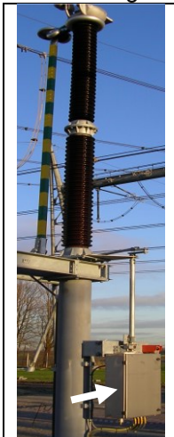
Afb. 5.4: HS-schakelaar met aandrijfkast
