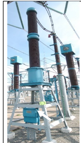
Afb. 5.6: Primaire spanningstransformator met aansluitkast
