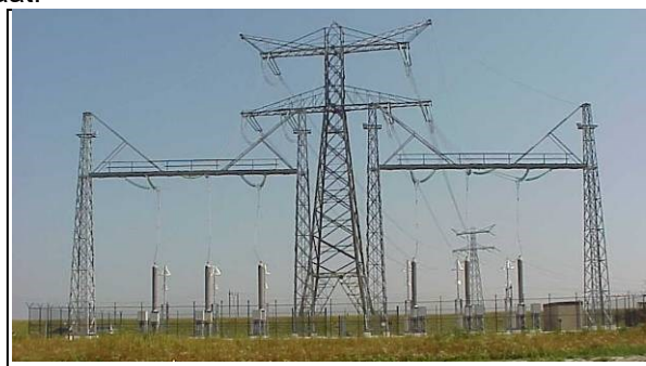
Afb. 3.6: Eindmast met afspanportaal en kabeleindsluitingen
