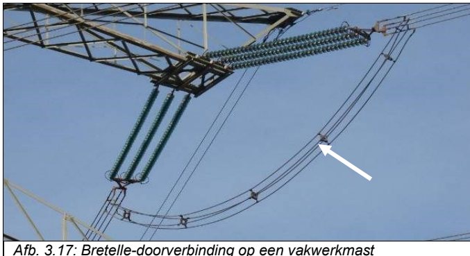
Afb. 3.17: Bretelle-doorverbinding op een vakwerkmast
