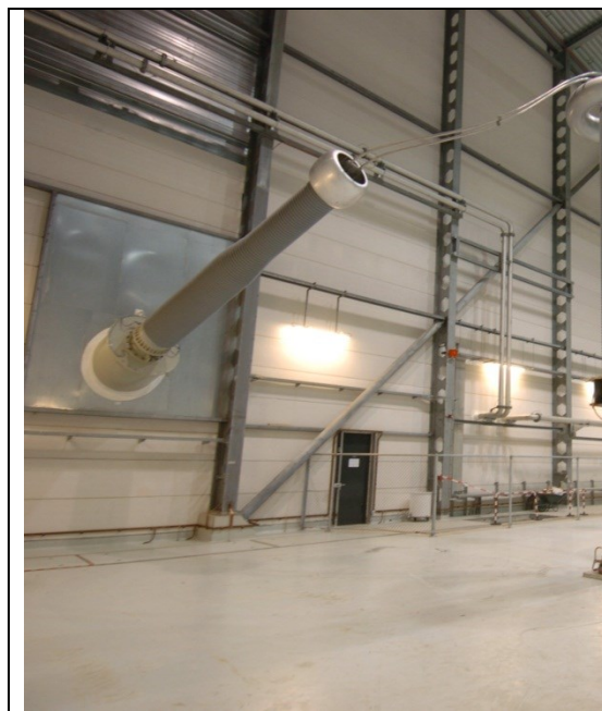
Afb. 4.16: Kabeleindsluiting (met muurdoorvoer) van een HVDC-kabel
