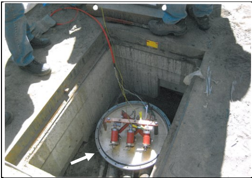
Afb. 4.13: Crossbondingput met de mantelaansluitpunten
