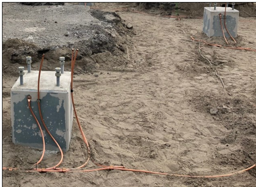
Afb. 2.35: Deel van het aardnet met uitlopers t.b.v. aansluiting op primaire componenten, het staalwerk en de fundering.
