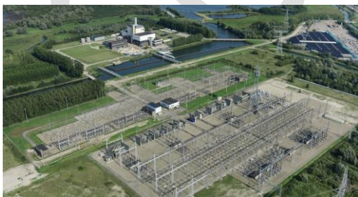
Afbeelding 1.2 380/150 kV-hoogspanningsstation in Diemen (bron: TenneT)
