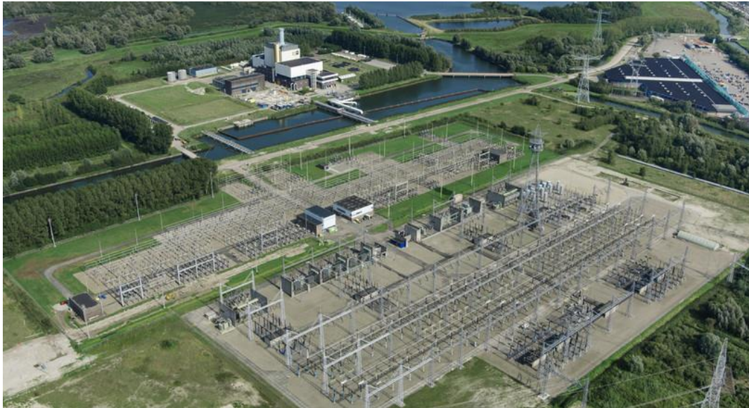
Afbeelding 1.2 380/150 kV-hoogspanningsstation in Diemen (bron: TenneT)
