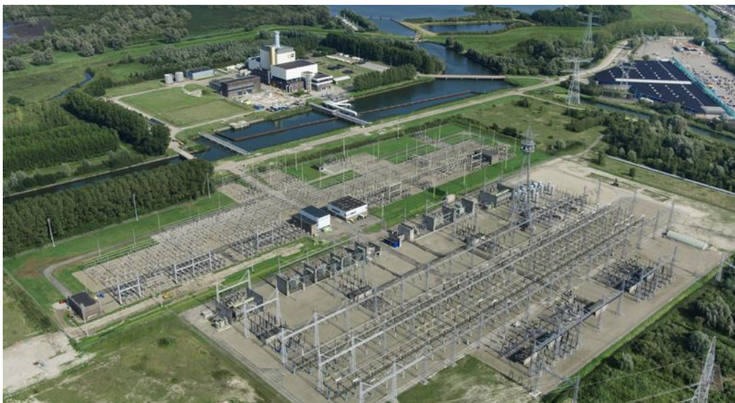
Afbeelding 1.2 380/150 kV-hoogspanningsstation in Diemen (bron: TenneT)
