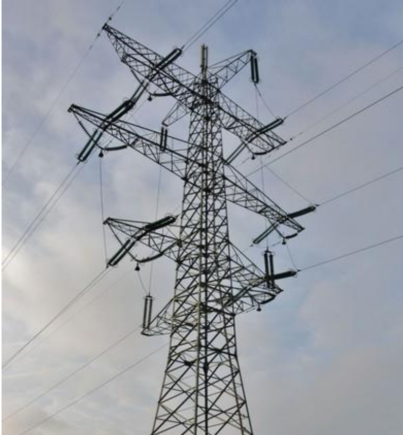
Afbeelding I.6 Wisselmast (bron: hoogspanningsnet.com)
