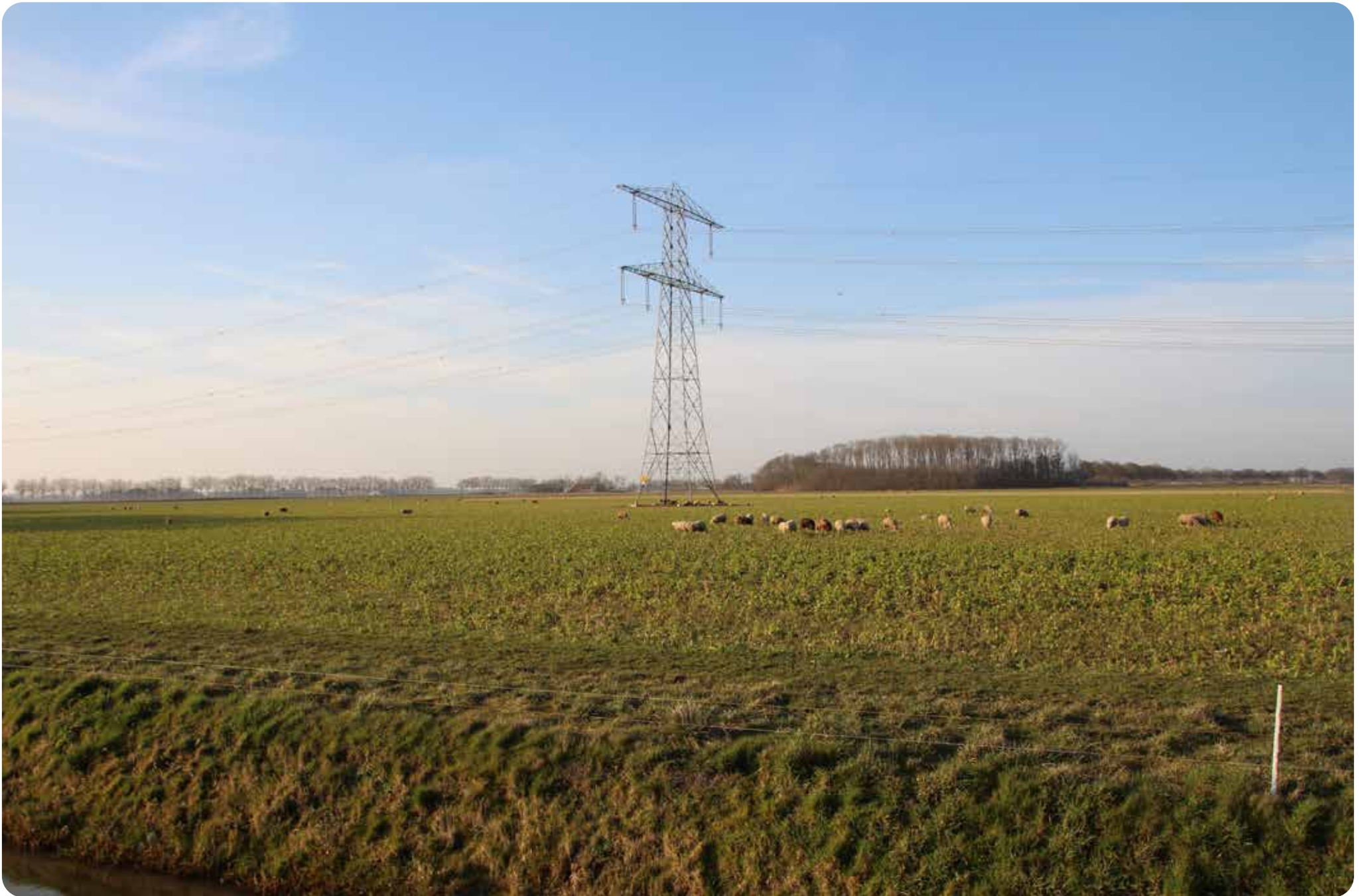
De huidige hoogspanningsverbinding langs de zuidzijde van schokland en omgeving, door het Werelderfgoed heen.
