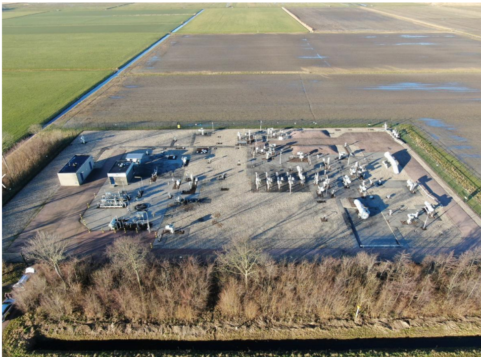
Figuur 5-3 Gasstation in Workum, vergelijkbaar met een aanlandingsstation voor waterstof
