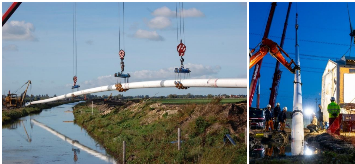
Figuur 4 links foto van een leiding die klaarligt voor een gestuurde boring. Rechts foto van een leiding die een boorgang in wordt getrokken.
