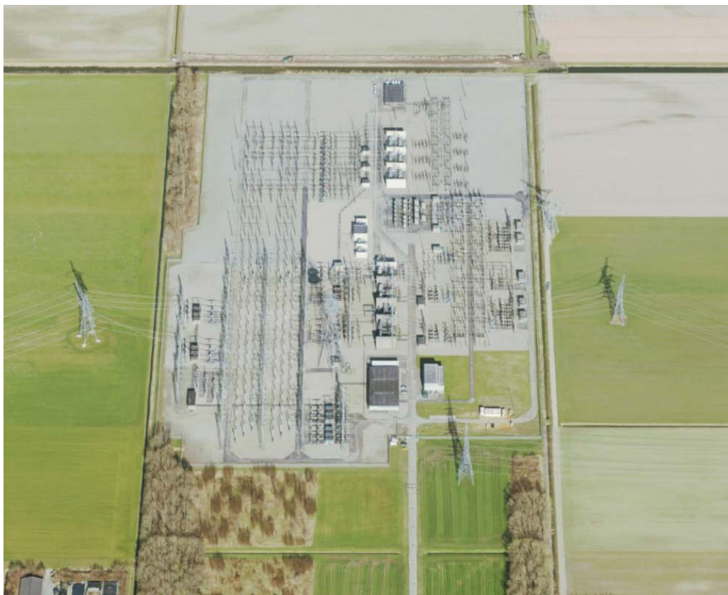
Figuur 1.2 Voorbeeld van een 380 kV-station (Hoogspanningsstation Ens)
