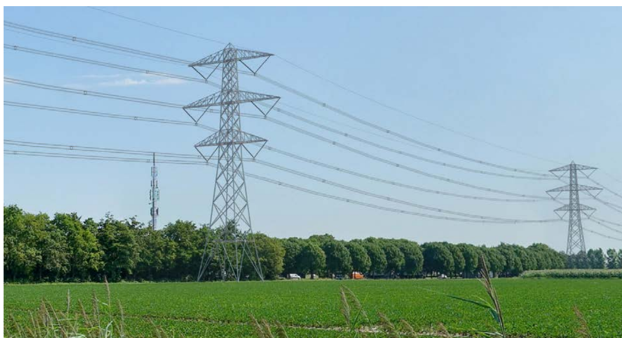
Figuur 5.3 Visualisatie van een Moldau mast in het landschap (bron: projectatlas Zuid-West 380 kV-oost)
