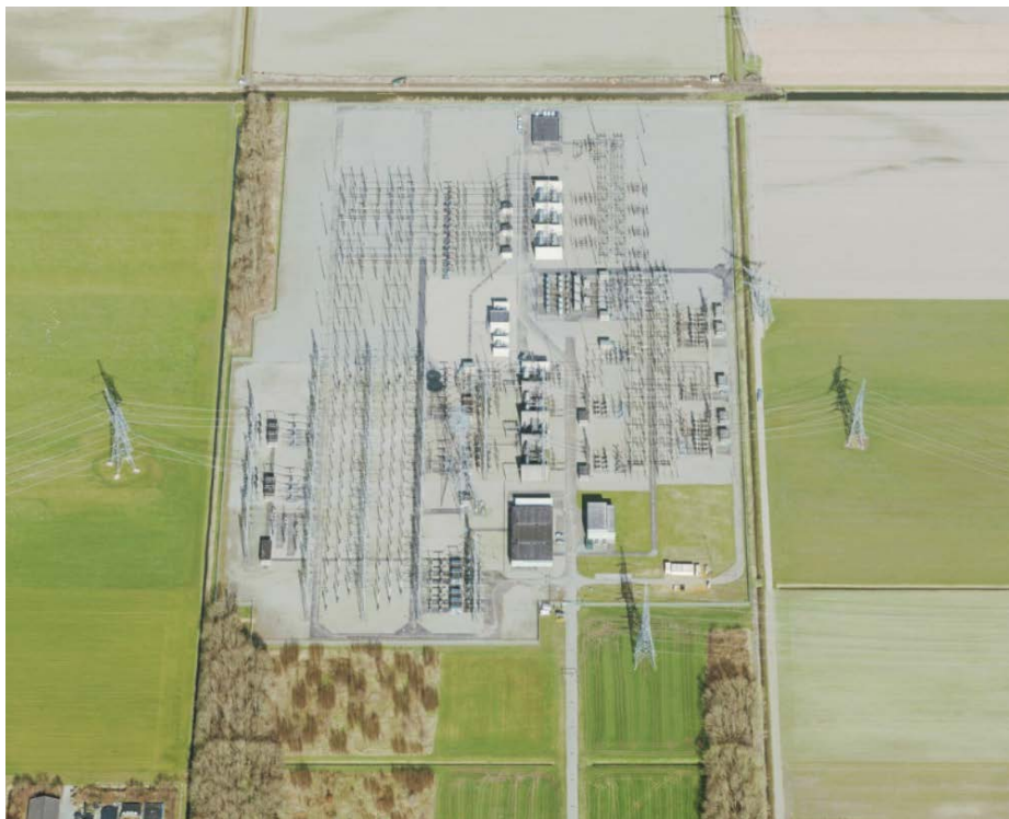
Figuur 5.6 Hoogspanningsstation Ens
