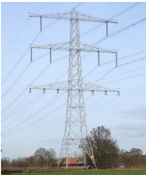
Figuur 3-6: Voorbeeld van een combimast, de 380kV fasen hangen hoog op de bovenste traversen, de lagere spanning onderin. (Bron: hoogspanningsnet.com)
