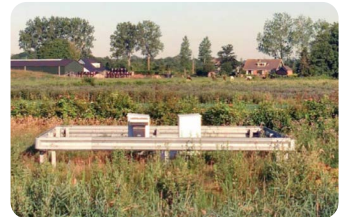
Foto van de aanrijdbeveiliging rond bovengrondse kasten (bij de moffen) bij de ondergrondse tracédelen in de 380 kV verbinding Vijfhuizen-Bleiswijk.
