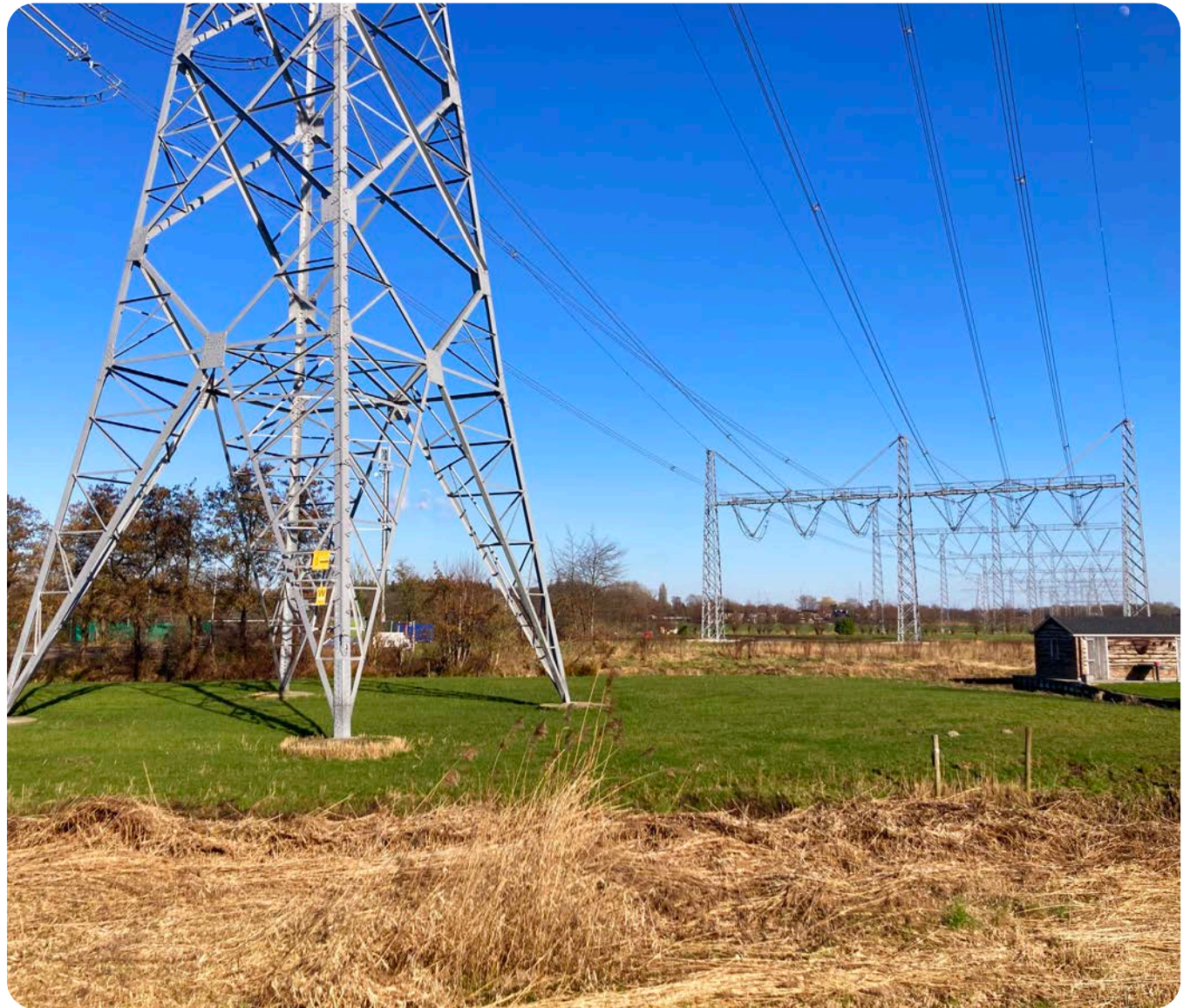
Overgang van verschillende masttypen; een Donaumast (links) gaat bij de bestaande 380 kV lijn tussen Diemen - Ens over in een portaalmast (rechts)
