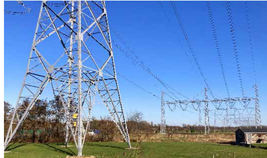
Afbeelding 20. Overgang van Moldaumast naar Portaalmast bij een 380 kV verbinding
