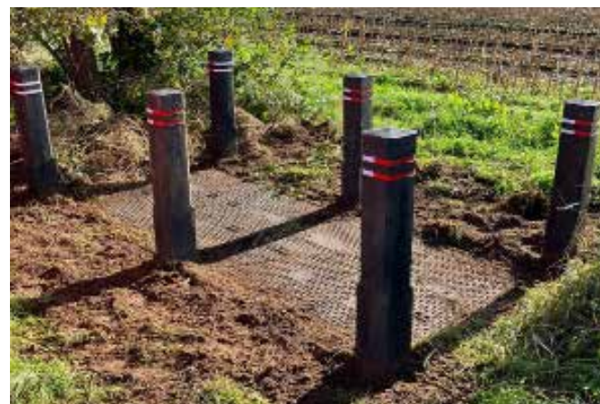
Afbeelding 72. Crossbondinglocatie (koppelplek) met aanrijbeveiliging (foto TenneT)
