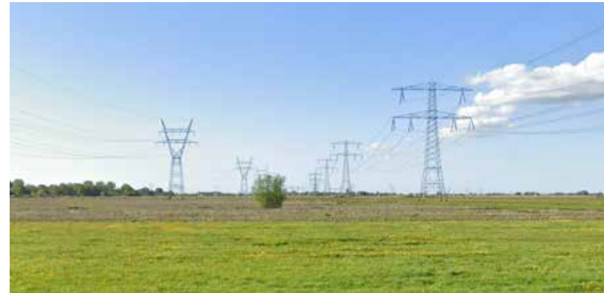
Afbeelding 59. Foto van een bestaande 380 kV donaumast (rechts) naast een bestaande 110 kV moldaumast bij Amsterdam. Bron: Google streetview
