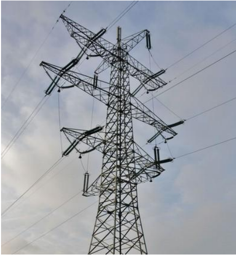
Figuur 7.6: Wisselmast (bron: hoogspanningsnet.com)
