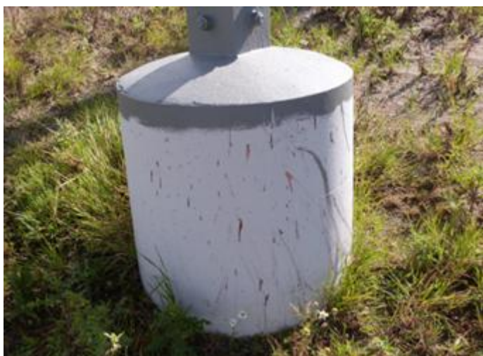
Figuur 1.16 Een voorbeeld van de verharding boven maaiveld van een mastvoet, bij een met beton gevulde stalen buispaal
