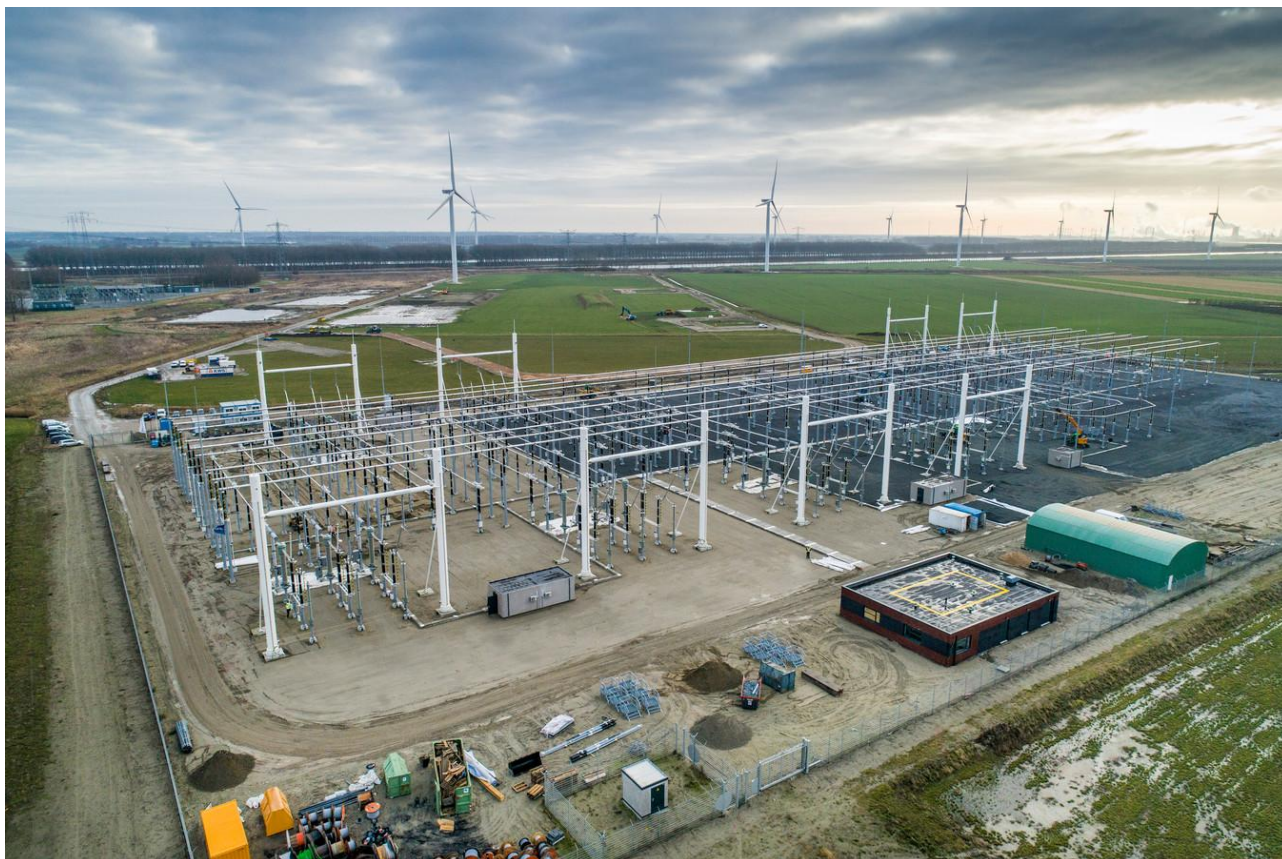
Figuur 7.1 Het in 2019 in gebruik genomen 380 kV-station Rilland, in Zeeland (bron: TenneT)
