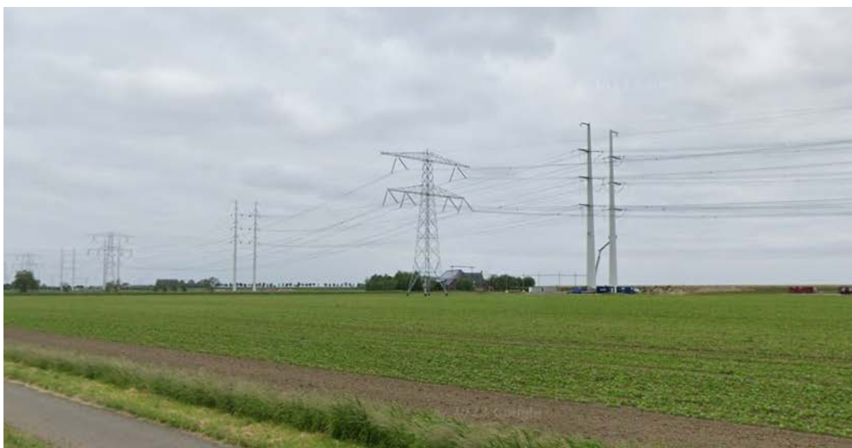
Figuur 2.2 Naast elkaar een 380 kV vakwerkmast ('Eiffeltoren') en een 380 kV wintrackmast (pilaren) (bron: Google Streetview, t.p.v. A58/N289 nabij Rilland)
